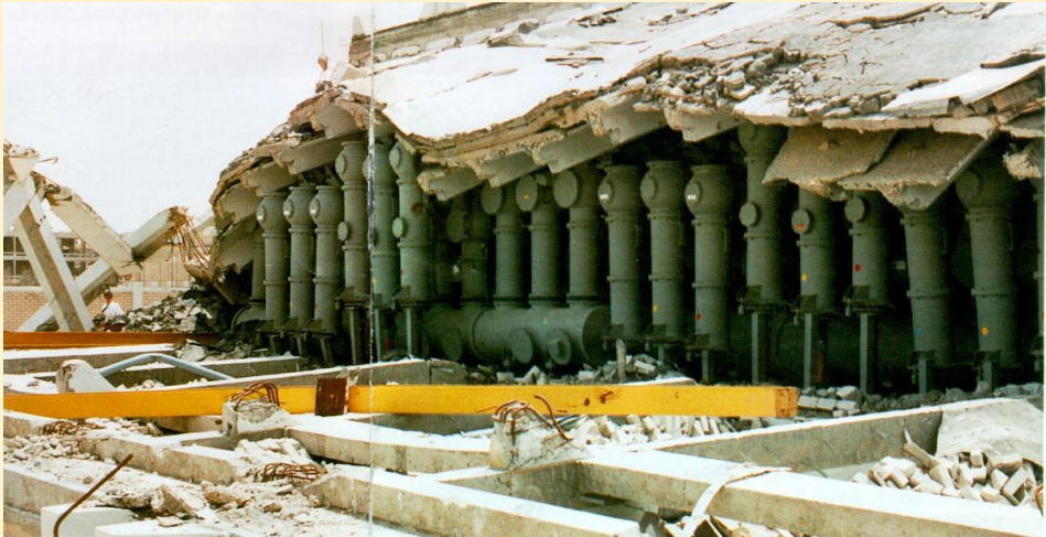
איור מס' 1: תחנת טרנספורמציה שהופצצה בזמן פלישת עיראק לכווית.
